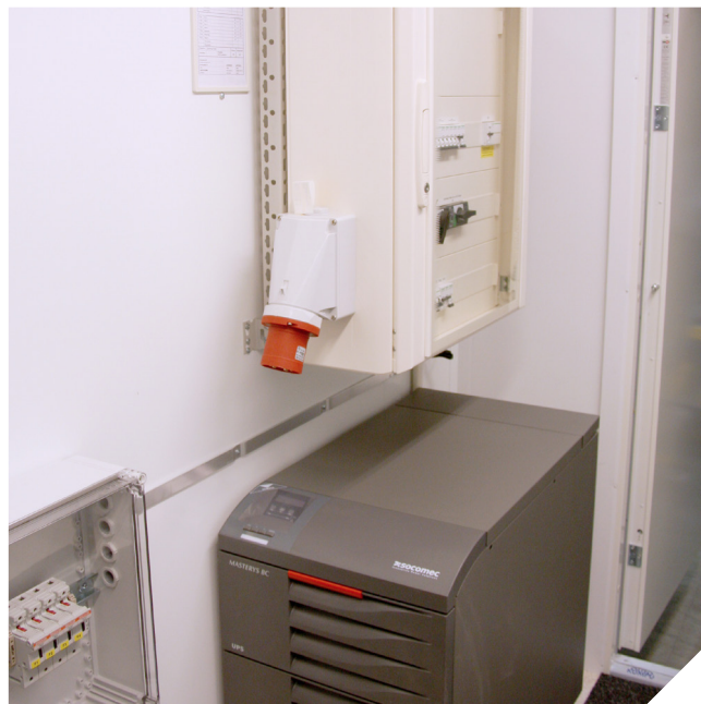
Elcentral med UPS- och reservkraftsintag
