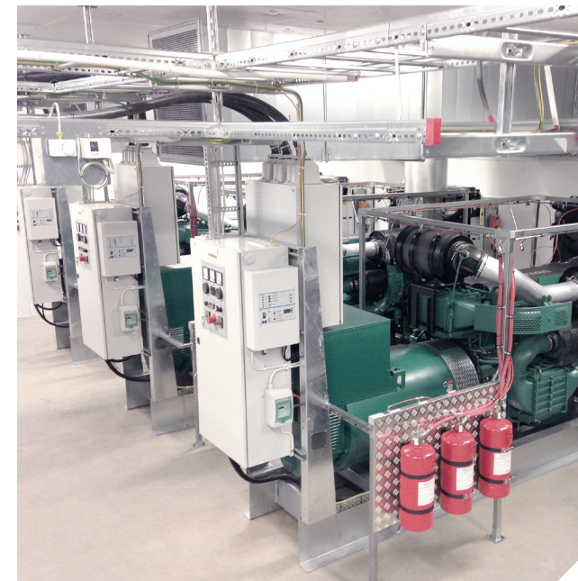
Stationärt installerat reservkraftssystem
