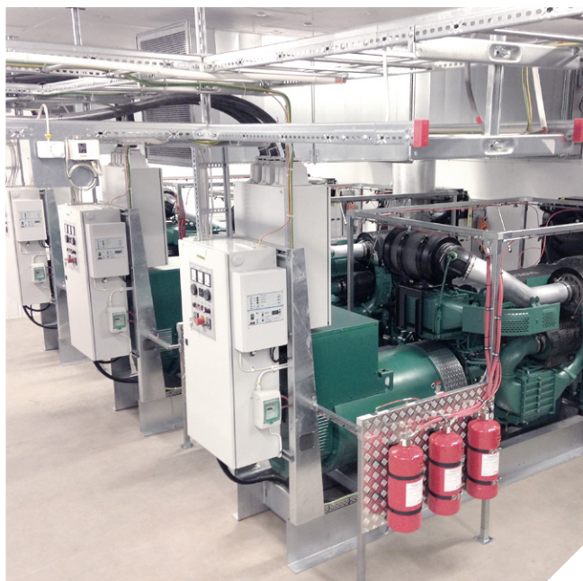
Stationärt installerat reservkraftssystem
